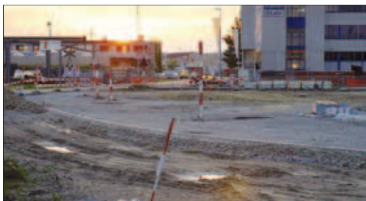
VERKEHR. Unabhängig von der F21-Frage hat der Stadtrat das «Verkehrskonzept Ost» realisiert. Bild: Baustelle des Kreisels Langdorfstrasse/Langfeldstrasse.
