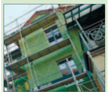
ISOLATION. Die Werkbetriebe sparen in ihrer Liegenschaft die Hälfte an Energie ein.
