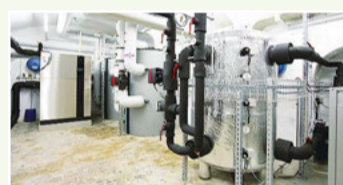
AUFGERÄUMT. Energiezentrale im Regierungsgebäude.
