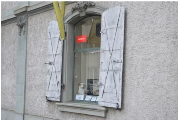
Abbildung 3: Denkmalgeschützter Metallfensterladen weisen vergrößerte Roststellen auf
