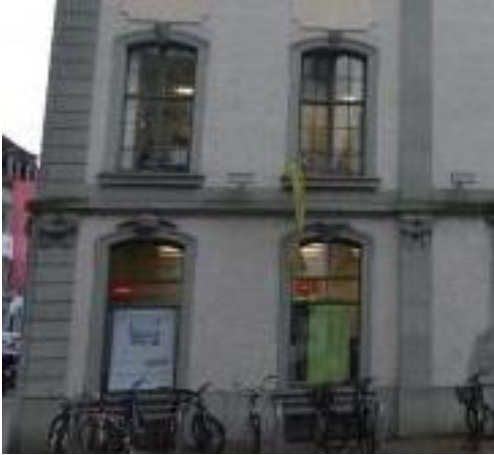
Abbildung 4: Fenster Erdgeschoss nur 1-fach verglast, Obergeschoss 2-fach verglast
