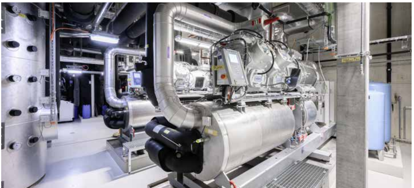
Hocheffiziente Wärmepumpen wandeln die thermische Energie in Nutzenergie um.
