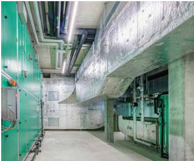
Die Heiz- und Lüftungsanlage ist riesig.
