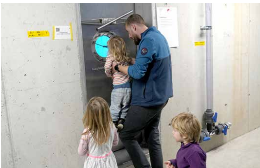
Perspektivenwechsel: Das Bullauge im Technik- raum ermöglicht Gross und Klein einen einmaligen Blick in das Rückhaltebecken.
