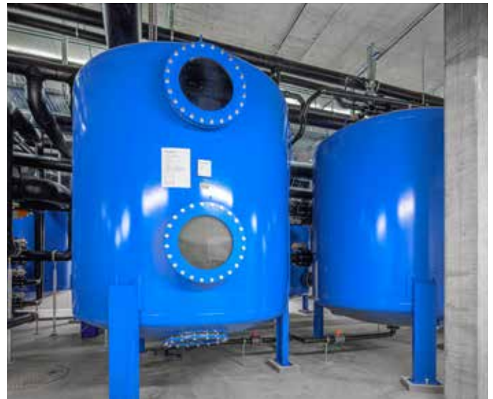
15 Filteranlagen reinigen laufend das Badewasser.
