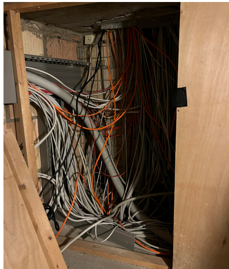
Abbildung 2: Beispiel für die veraltete Gebäudetechnik
